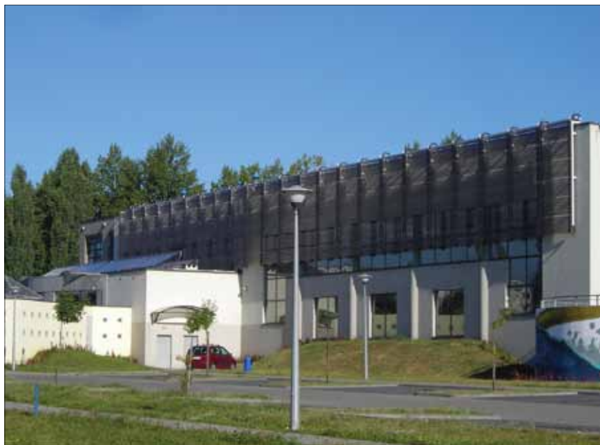
Kolektory próżniowe KSR10 na elewacji pływalni krytej
