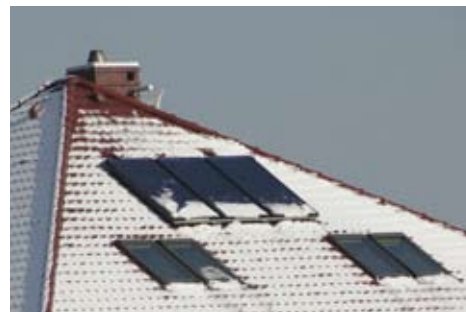
Rys. 5. Kolektory płaskie z warunkach zimowych uzyskują szybką gotowość do pracy, samoczynnie usuwając śnieg i szron z powierzchni szyby
