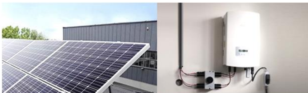
Wysoka efektywność instalacji fotowoltaicznej to przede wszystkim zasługa paneli PV oraz inwerterów
